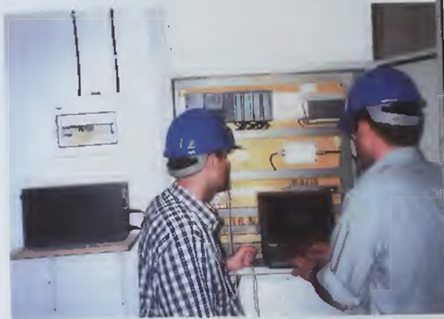
Τοπικός Σταθμός Δεξαμενής Στρατοπέδου.
