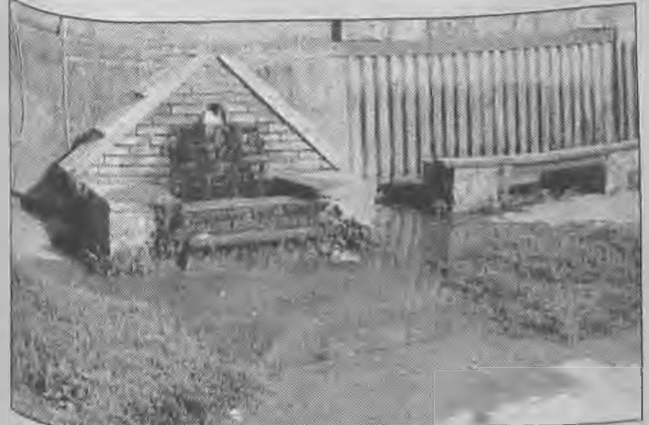
Η βρύση στο πάρκο του Λιανοβροχίου η οποία από πηγή δροσιάς μετατρέπεται σε πηγή ...κινδύνου.
