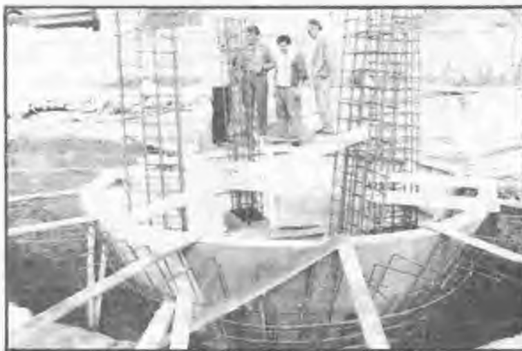
Ένα από τα τμήματα χημικής επεξεργασίας των λυμάτων της Μονάδας Βιολογικού Καθαρισμού.
