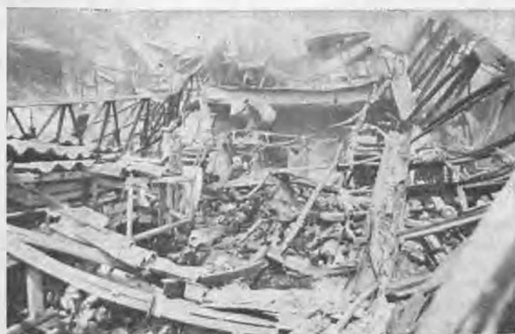
Μια εικόνα της μεγάλης καταστροφής που προκάλεσε η φωτιά στο εργοστάσιο πλαστικών του Αχ. Τσαμπήρου (Φωτογραφία «Φωτο ΠΑΛΛΑΣ»)
