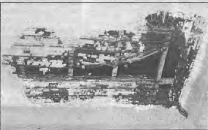
Οι σοβάδες έπεσαν, ευτυχώς δεν τραυμάτισαν κανένα αλλά αποκάλυψαν την...ιστορία του κτιρίου.
